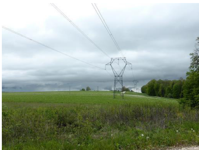
Ligne haute-tension traversant le territoire
